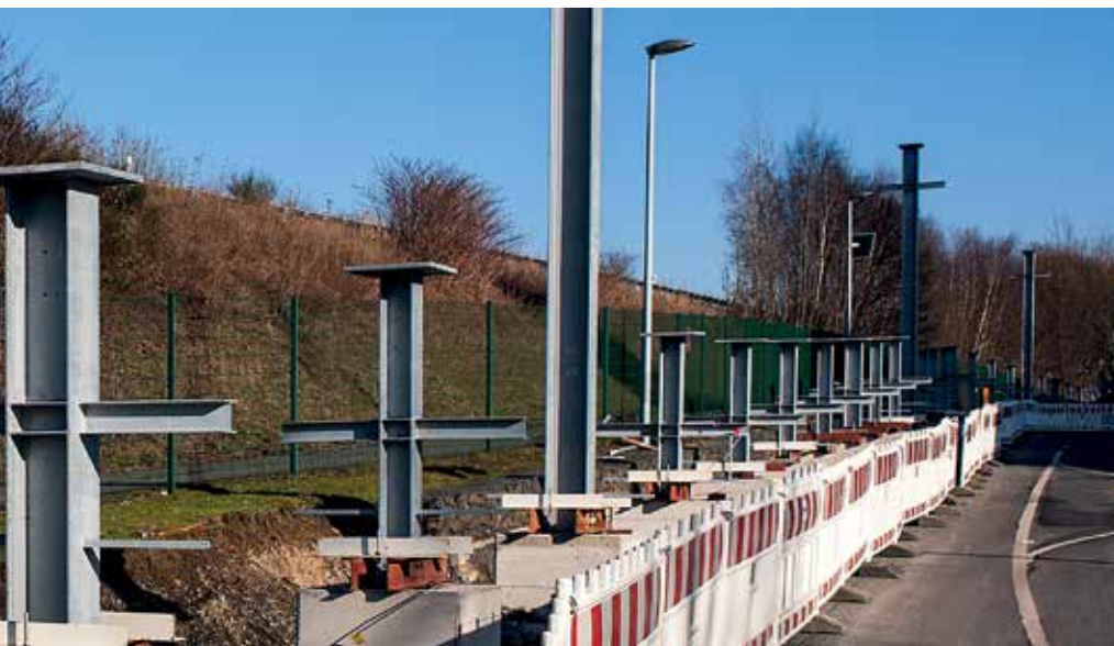
Rohrtrasse für die Fernwärmeleitung zur Talachse.
